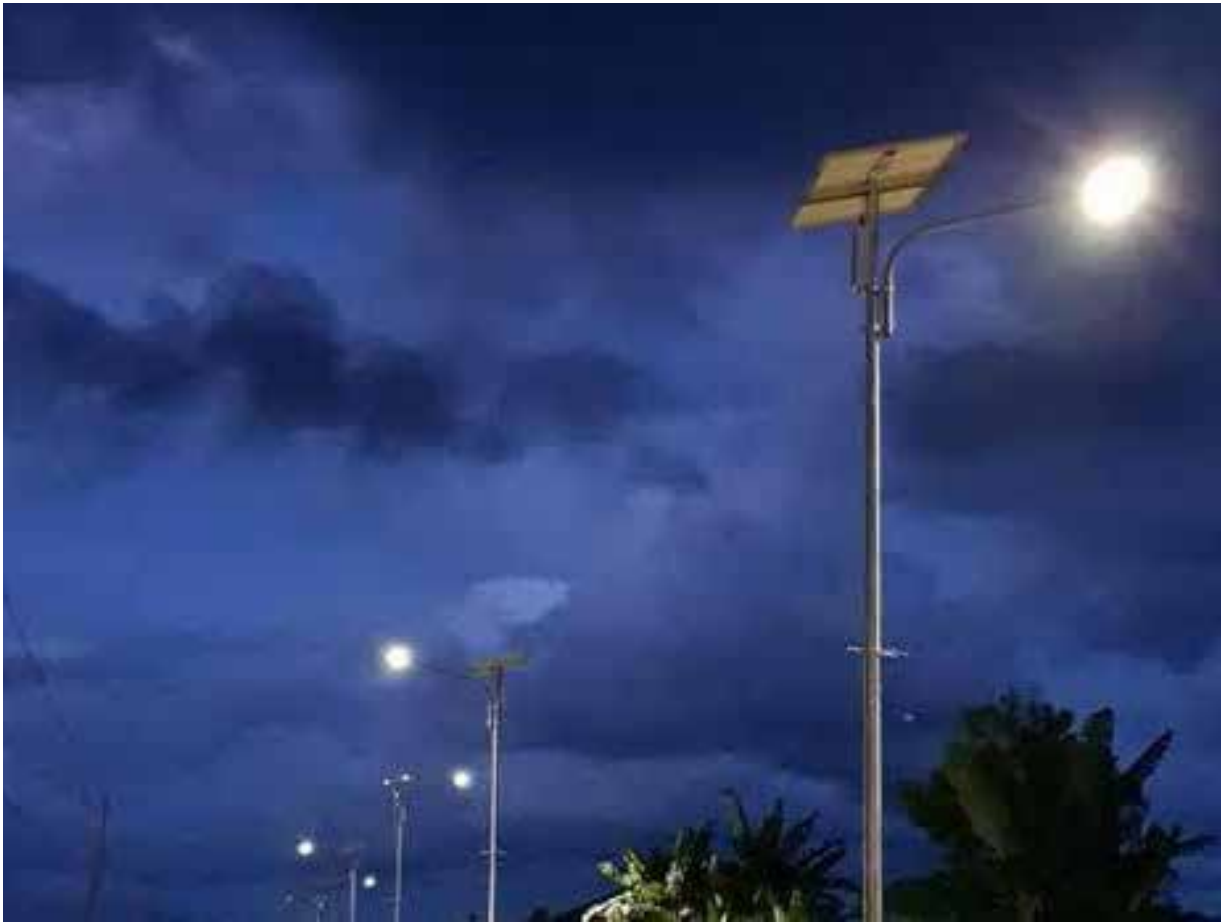
Lampu Penerangan Jalan di Desa Tanjung Batu, Kukar. (Istimewa)
