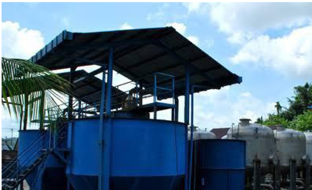
Pompa air Perumda Tirta Mahakam. (Istimewa)
